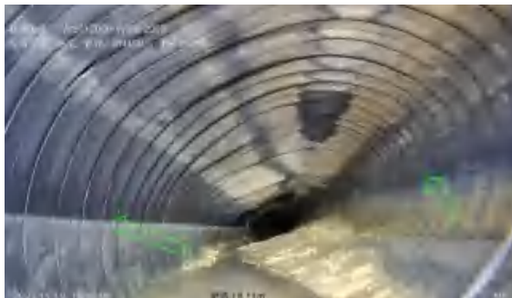
新桥大道污水四级变形病害
