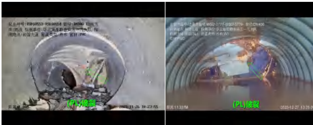
兴业大道雨水四级破裂病害
