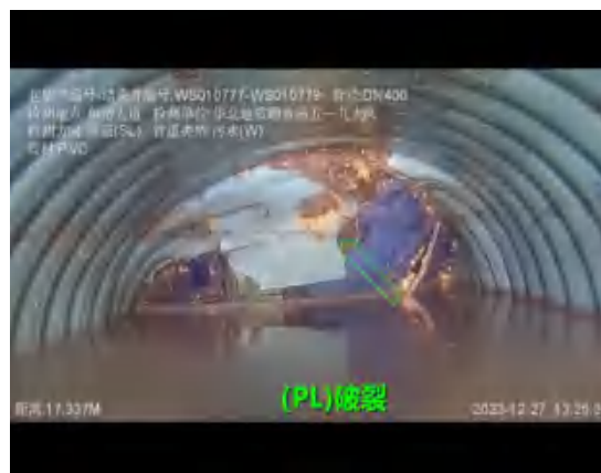
和谐大道污水四级破裂病害
