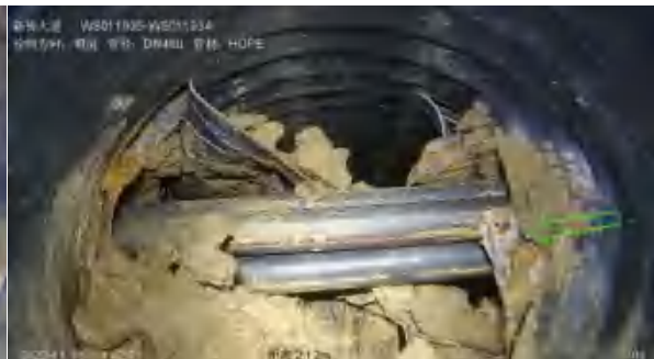
新桥大道污水四级破裂病害
